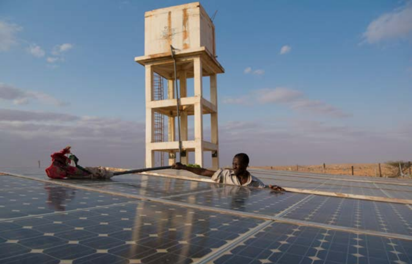
Solcelleanlegg som driver pumpen til Kirkens Nødhjelp sin brønn i Garowe, Puntland i Somalia. Foto: Håvard Bjelland
